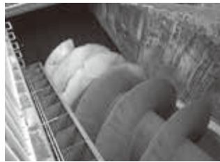
機械設備 (スクルーポンプ)
